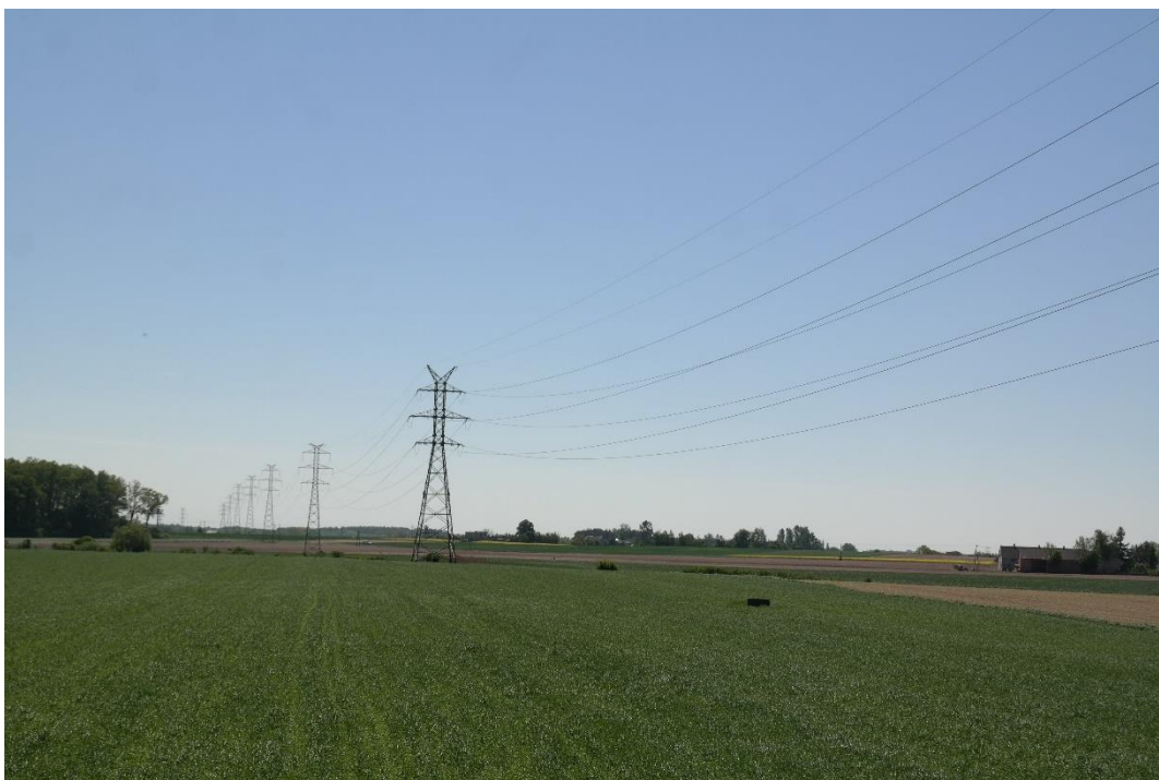
Zdjęcie 39. Linia elektroenergetyczna najwyższych napięć
